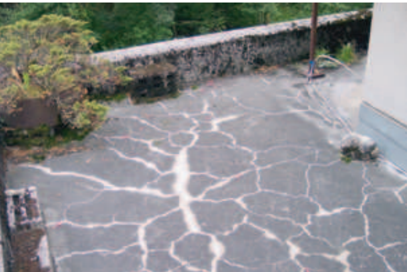
Wasser dringt in die Balkonkonstruktion und verursacht grosse bauliche Schäden.
